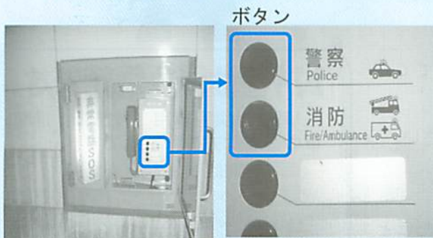
宇樽部トンネル非常用電話
